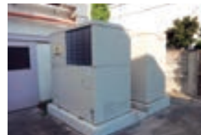
自家発電設備
