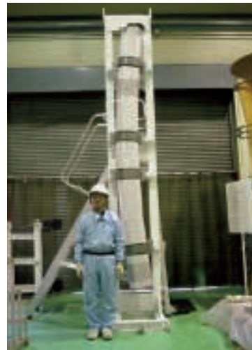
偏向電磁石用Bユニットダクト外観
